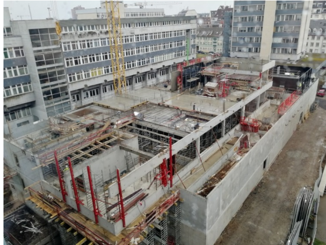
Mars 2018 : Phase Gros-Œuvre – Réalisation de la dalle béton du 3 ème étage @E Saint-Dizier
